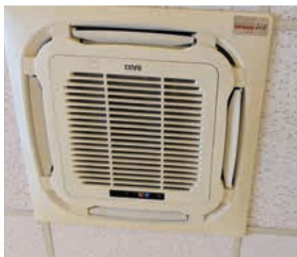
L'impianto di condizionamento.
